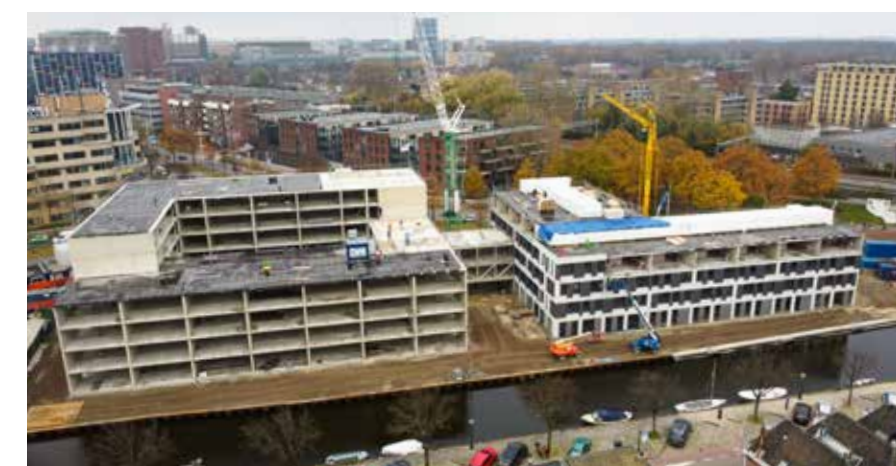
Voor de studentenwoningen van The Fizz in Leiden is op advies van Stabiel Management gekozen voor een prefab casco met twee vloertypes, van twee fabrikanten.
